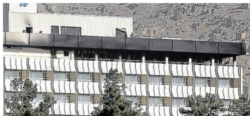
Ausgebranntes Dach des Intercontinental-Hotels in Kabul: Wie kamen die Angreifer in das Gebäude? Foto: dpa
